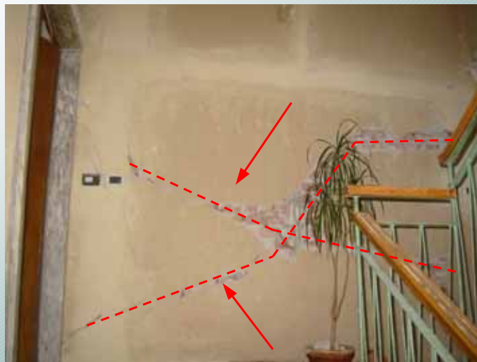
Muratura centrale di spina con lesioni a taglio nelle due direzioni
