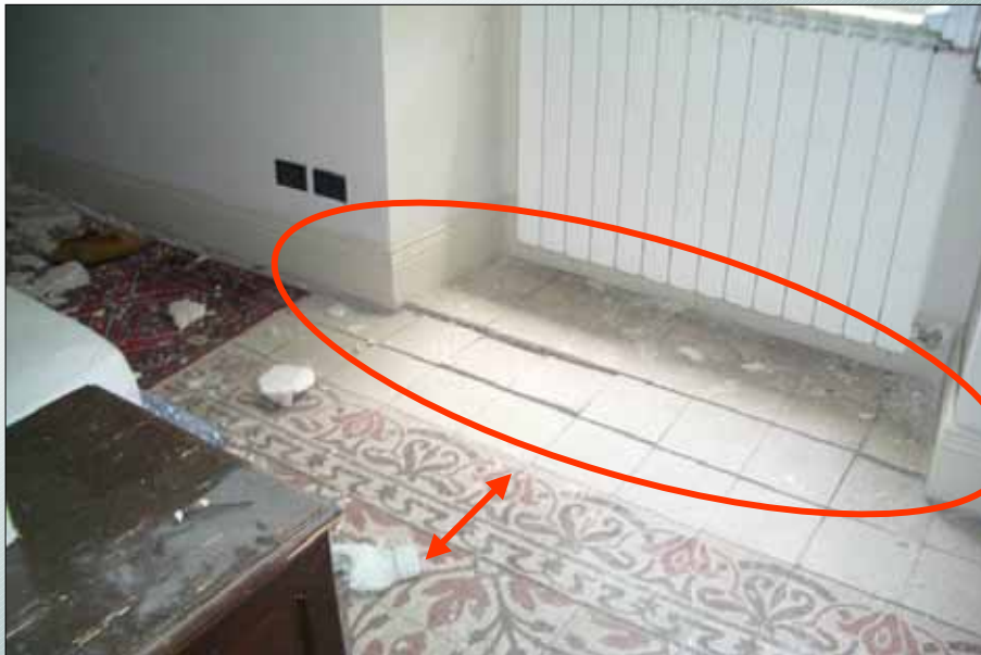
Distacco del solaio dalla parete esterna con possibili fenomeni di fuori piano (mancanza di cordoli e catene)
