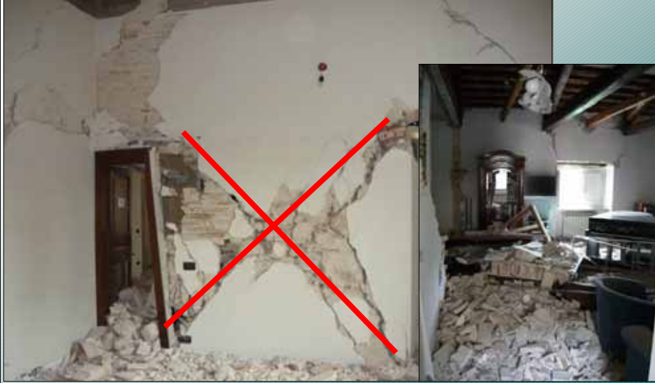
Plasticizzazioni delle murature portanti con rotture a taglio
