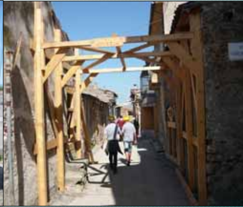
Puntellamento di contrasto tra due edifici con rischio di una vulnerabilità sismica indotta per effetto di interazione strutturale in caso di ripetizioni sismiche
